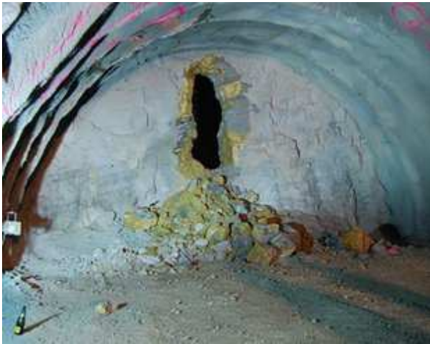
Una imatge de la cala del túnel del TAV de Sarrià de Ter. Foto: J.NADAL.
