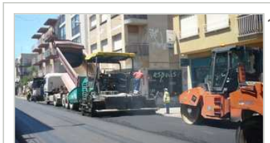
Aglomerats Girona és l'empresa que està executant l'actuació de millora viària. Foto: A.V.
