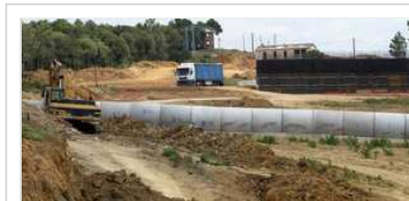
El tram de l'N-II entre Medinyà i Orriols, ahir al migdia ja sense cap treballador, i amb les obres empantanegades. Foto: MIQUEL RUIZ.
