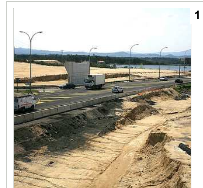
Estat de les obres de l'N-II a l'alçada de l'encreuament de Caldes. Foto: MANEL LLADÓ.
