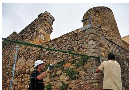
Els operaris col·locant les tanques de protecció de l'obra. diari de girona
