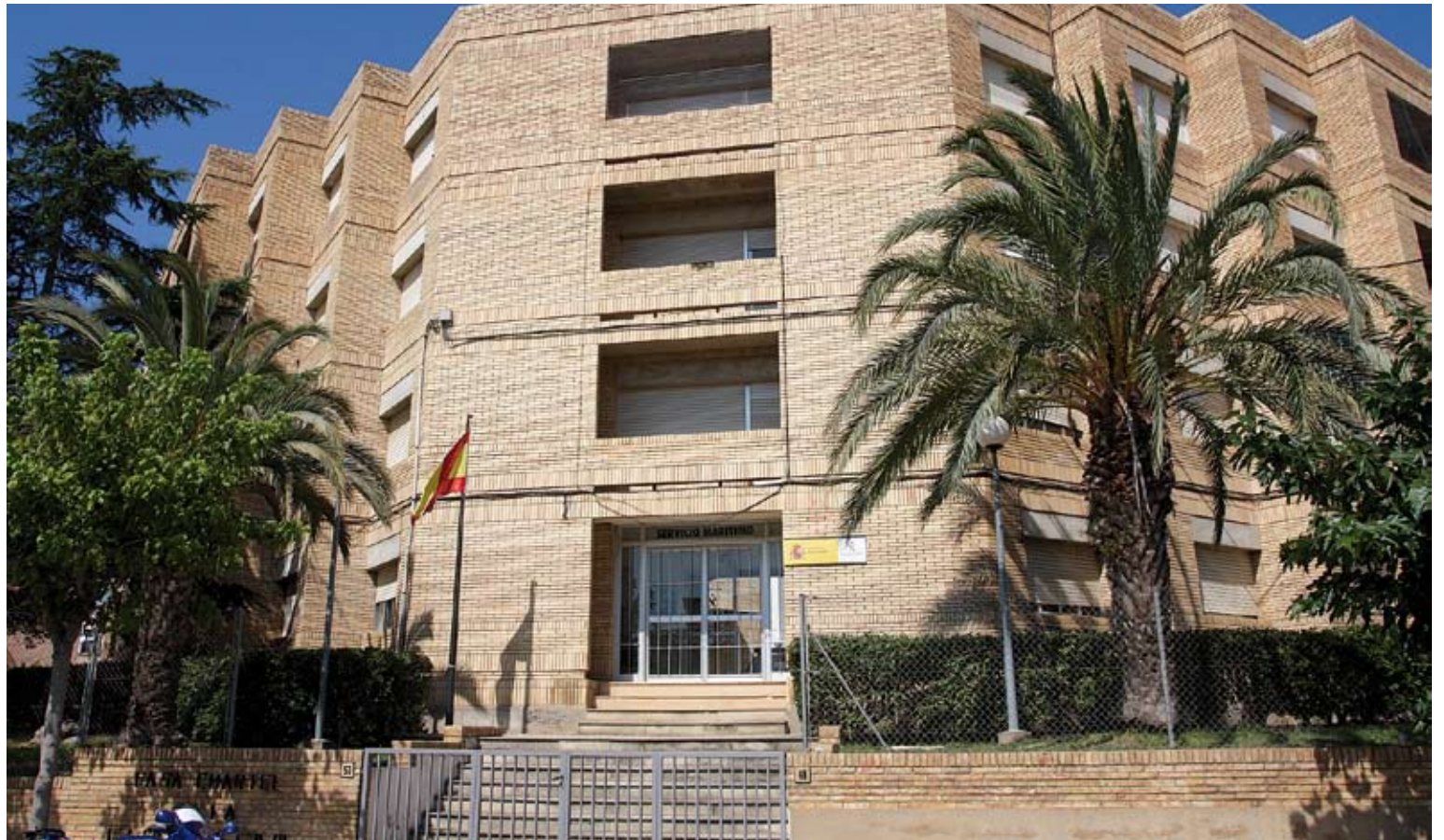
L'ESCALA. És la caserna que va rebre una inversió més elevada (1.051.483,62 euros) i s'hi han restaurat la coberta i les obertures
