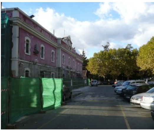
Una visita de les obres que es fan a l'estació de Ripoll. Foto: J.C..
