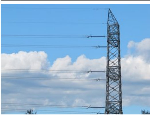
L'última de les torres de la línia de 400 kV a Bescanó, abans d'arribar a les subestacions. Foto: JORDI NADAL.
