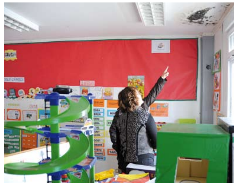
FALTA DE MANTENIMENT. Alguns mòduls tenen filtracions d'aigua
