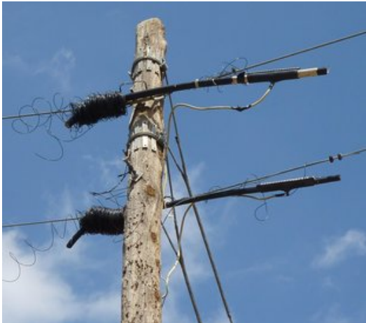
Cablejat telefònic que els lladres van tallar a l'estiu a la GIP-5101 entre Avinyonet de Puigventós i Cistella Foto: Ò.P.
