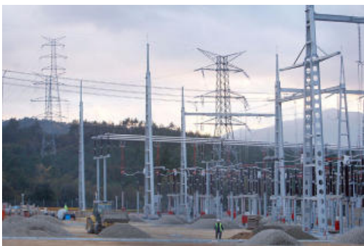
La subestació de Bescanó, en una imatge d'arxiu d'aquest novembre.<br/>
