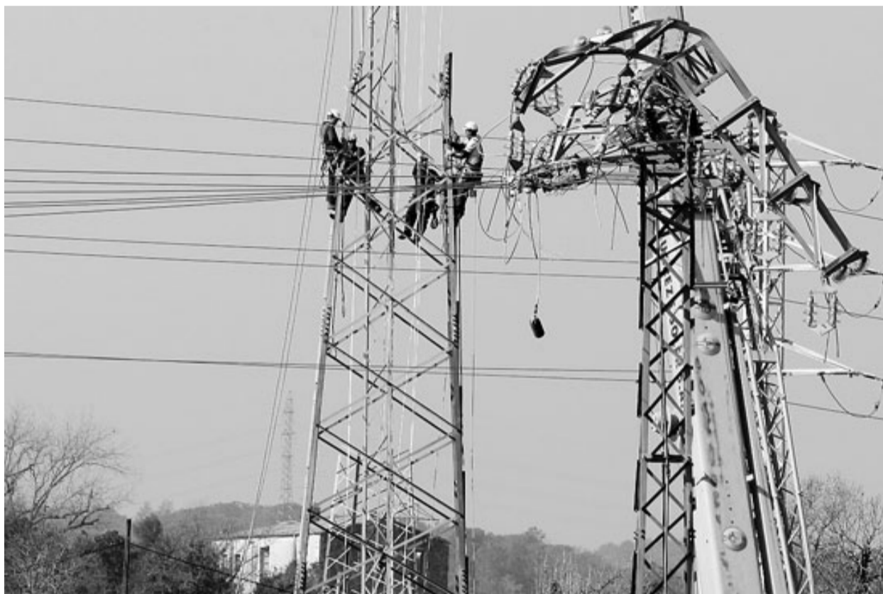
Uns operaris preparant ahir al migdia l'estructura per fer passar els cables elèctrics per sobre de l'AP-7. / LLUÍS SERRAT
