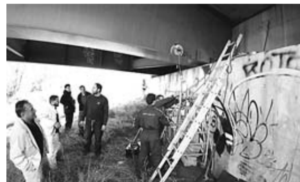
Una imatge de les feines de reparació del pont sobre la Muga a Castelló d'Empúries ■ LLUÍS SERRAT
