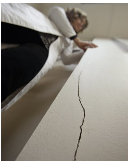
Una de les esquerdes a la Clínica Mandri, situada davant per davant del pou que s'hi perfora per fer l'estació Foto: ROBERT RAMOS.
