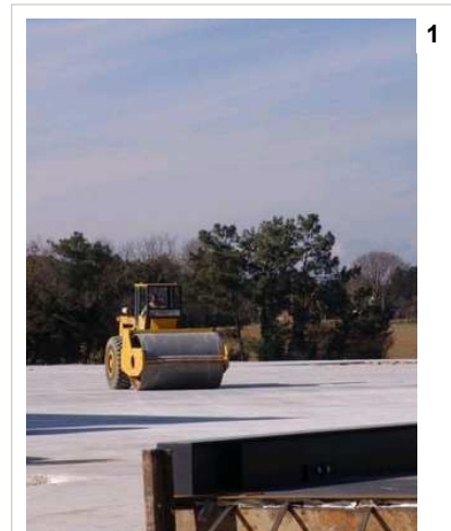
Una màquina treballa en les obres d'asfaltament on s'ubicarà la nova planta de reciclatge a Vilobí. Foto: J.M.S.
