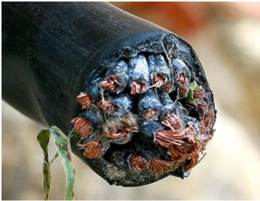
Detall del cable tallat. Foto: M. LLADÓ..
