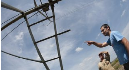
L'aspensor de Can Gep Xai de Cassà de la Selva amb el cable tallat, i les persones que el reparaven. Foto: LLUÍS SERRAT.
