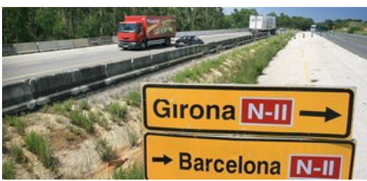
Les obres de l'N-II entre Sils i Caldes van quedar aturades fa dos anys. Foto: MANEL LLADÓ.
