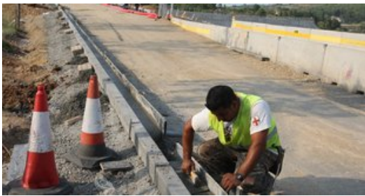
Un operari en el nou vial de l'antiga carretera de Banyoles per sobre l'autopista al pas per Sant Julià de Ramis Foto: LL.SERRAT.
