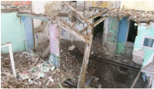
Aspecte de la finca afectada per l'esfondrament. Foto: AJUNTAMENT DE RIPOLL.
