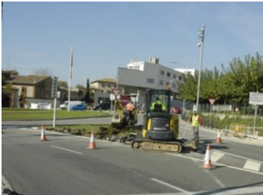
Les obres de seguretat vial han començat al giratori dels Lledoners. Foto: A.V.
