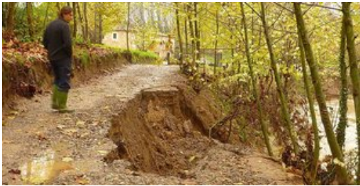
L'estat en què va quedar el camí de la Central, a Santa Llogaia. Foto: R. E.
