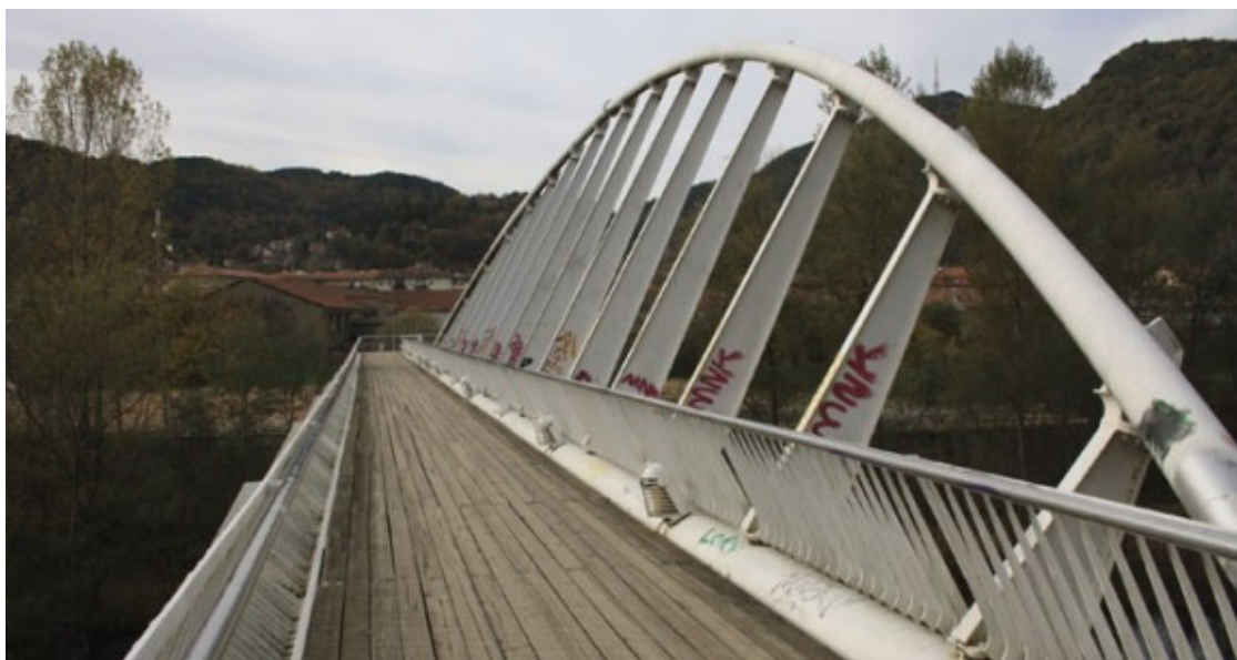
El PUOSC permetrà eliminar les barreres arquitectòniques del degradat pont de Calatrava de Ripoll. Foto: AU
