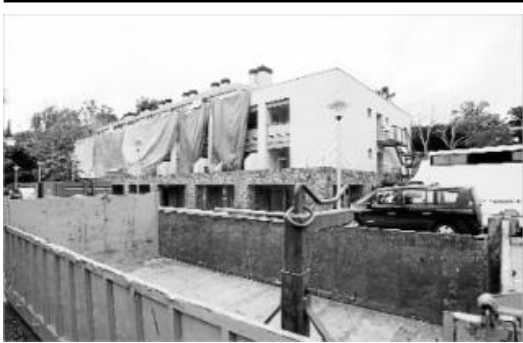
L'edifici de l'Armonia el desembre de 2007, quan es va procedir a l'enderroc dels interiors.
