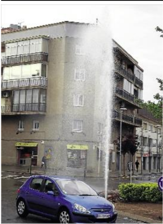
Roses Una fuga amb un raig de deu metres
