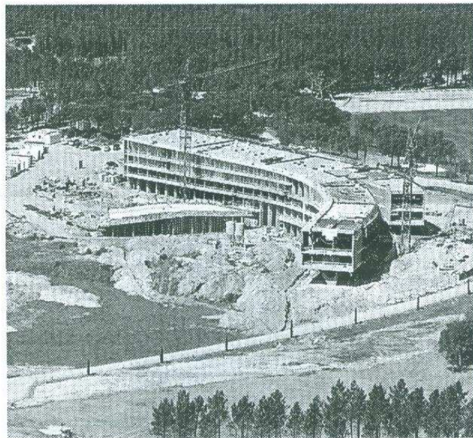
Vista aèria en què es pot comprovar l'estat de les obres. / EL PUNT.
