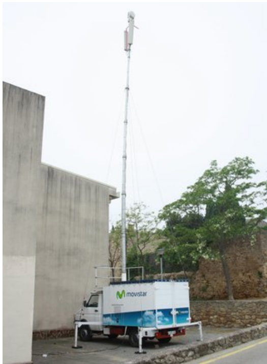
Antena de telefonia mòbil provisional que fa cinc anys que Movistar hi té instal·lada. Foto: JOAN PUNTÍ.
