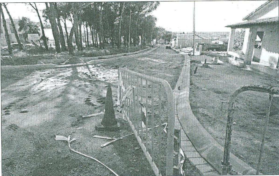
En obres. La rotonda que s'està construint acabarà amb un dels punts negres d'accés a la localitat.
