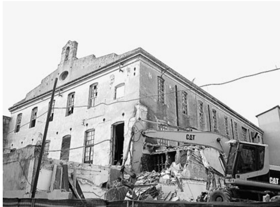
Una excavadora executa l'enderroc dels edificis annexos a la Marfà. / MANEL LLADÓ
