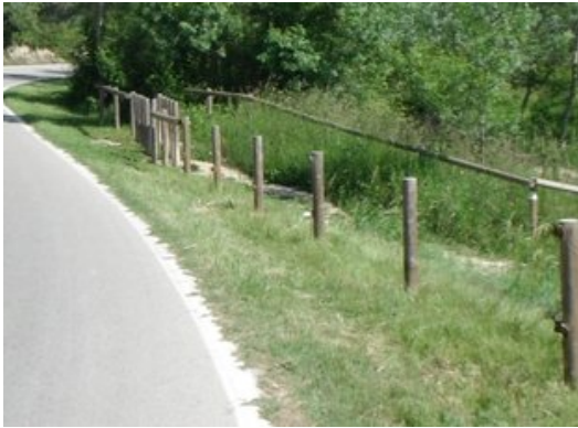
El tram afectat pel robatori , situat a la part nord-oest de l'estany. Foto: CONSORCI DE L'ESTANY.
