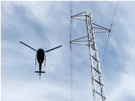
Una imatge d'un helicòpter d'Endesa, en la revisió de termografia de les línies de mitja tensió. Foto: EL PUNT AVUI.
