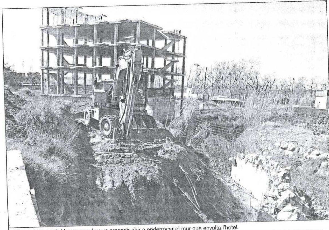
Mur enderrocat. Una excavadora va procedir ahir a enderrocar el mur que envolta l'hotel.
