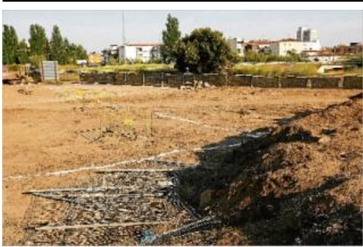
Els terrenys on s'alçarà la piscina mancomunada s'han desbrossat i es preparen per 14 mesos d'obres.
