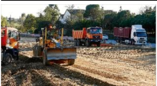
Les màquines treballen per desbrossar i anivellar el tram entre Sils i Caldes de Malavella.
