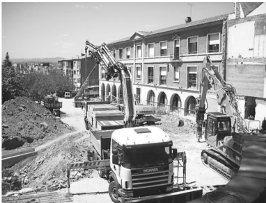
Tot el pati de l'escola Annexa de Girona està ocupat per les obres d'ampliació. / D.V.
