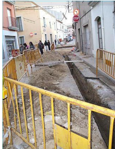
Les obres han comportat aixecar l'asfalt i les voreres en molts punts. diari de girona
