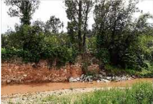
La riera de Santa Coloma on es veu que el mur de pedra ha caigut.
