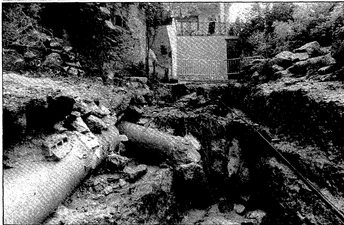
L'aiguat ha causat danys greus a les instal·lacions de butà a Caldes de Malavella, així com també en alguns carrers de la vila. Fotos: Joan Castro.
