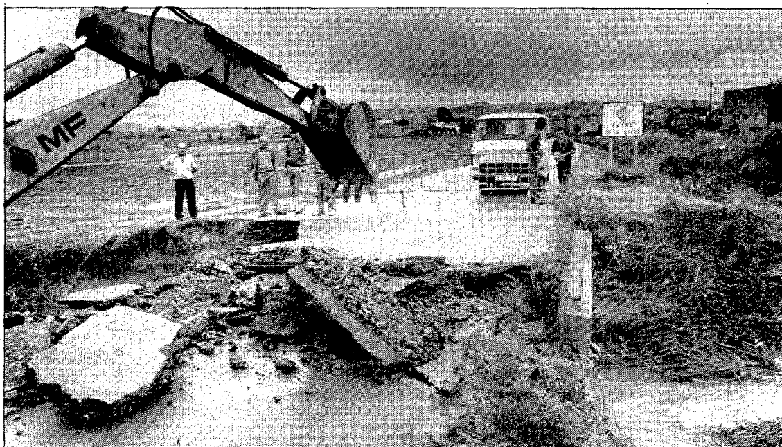
La carretera de Cassà a Caldes va quedar tallada per l'enfonsament d'aquest petit pont. Foto: Joan Castro.
