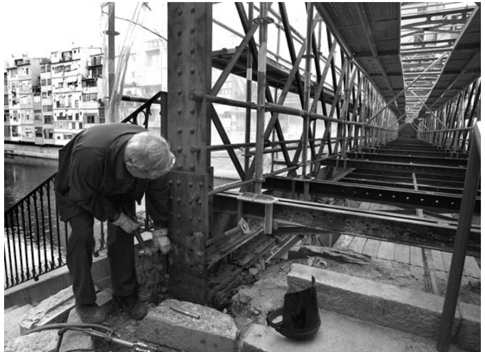
Imatge dels treballs que s'estan fent al pont de ferro de Girona, dimecres. / MANEL LLADÓ
