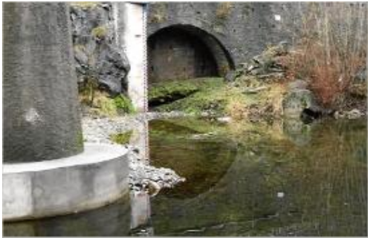
Estació d'aforament del Ter al seu pas per Ripoll.
