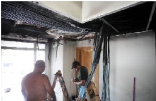
L'incendi es va originar a la caixa de comptadors elèctrics.
