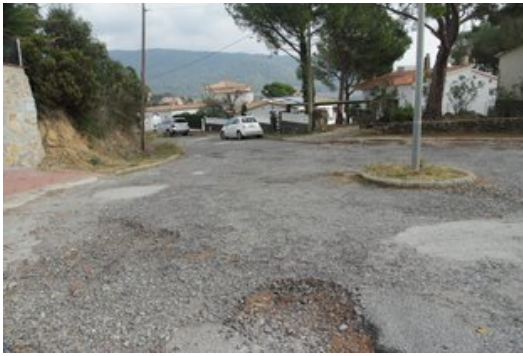
El mal estat de l'asfalt és el problema més pal·lès als carrers del Mas Pere de Calonge Foto: E.A.
