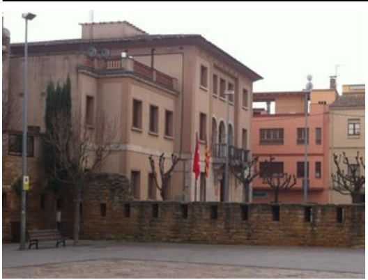
L'ajuntament de la Bisbal repararà la coberta per evitar la caiguda de teules. Foto: JOAN PUNTÍ.
