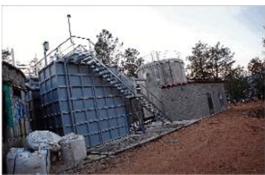
Una imatge d'arxiu de la planta potabilitzadora d'aigua a Anglès.
