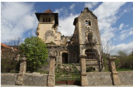
La façana de Can Roig visiblement deteriorada pel pas del temps. Foto: JORDI PUIG / EL 9 NOU.
