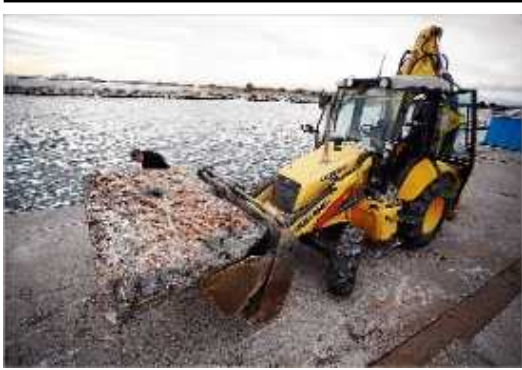
El dic de recer, amb el paviment en molt mal estat.
