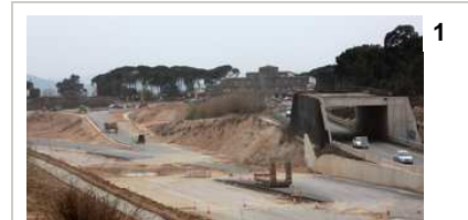
Les obres de la N-II davant l'entrada a Caldes de Malavella. Al fons, el restaurant La Llotja. Foto: JOAN SABATER.
