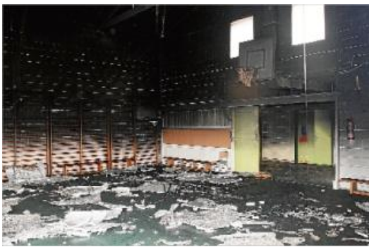
L'equipament esportiu del col·legi Mare de Déu dels Socors va quedar molt afectat per l'incendi.
