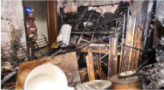
Els baixos van quedar afectats per les flames i també l'escala · Marc Martí
